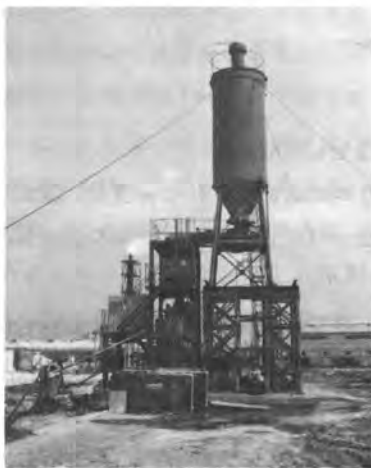
写-1 硬化材プラント
