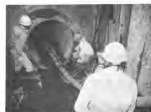
立坑部のフレキシブルホース
