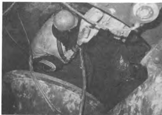
スクリューコンベア脱状況
