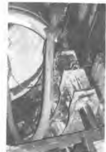
立坑部のフレキシブルホース
