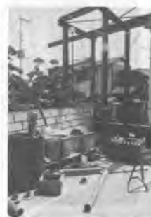
泥水タンク・油圧ユニット とコントロール ユニット
