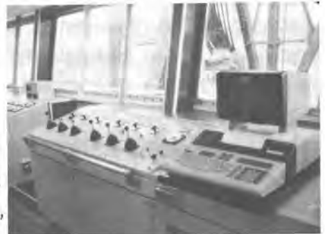
写真-2. 中央制御室の計算機
