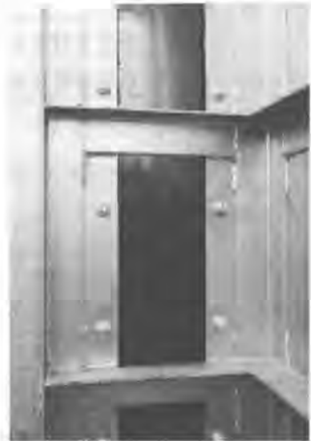
写真-3 フロックフィルター槽
