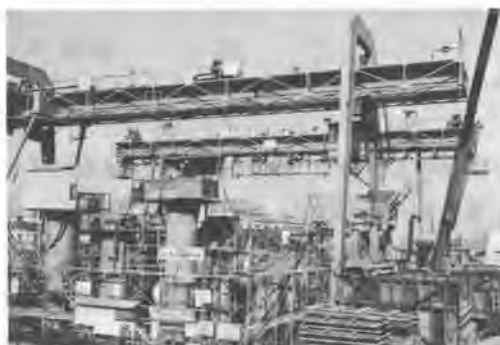
写真-1 装置の全景
