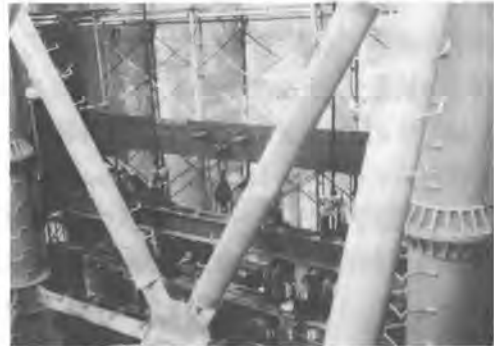
写真-3 押上げ装置
