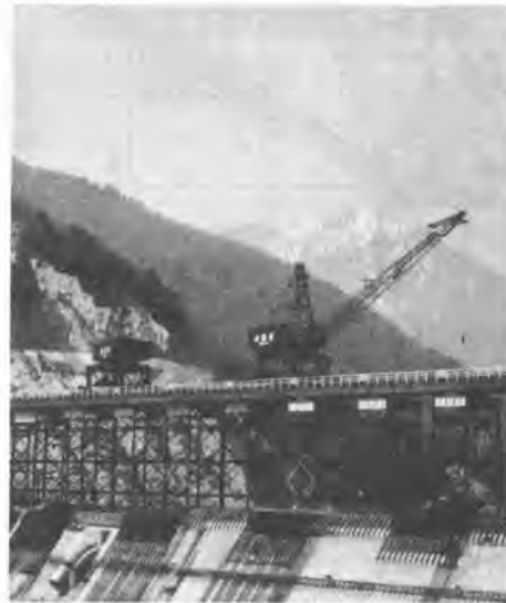
写真-1 大町ダムの走行式ジブクレーン
