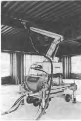
写真-1 SSR-2の外観
