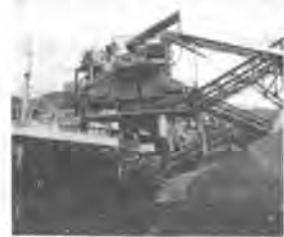
写-2 生コン工場稼動状態
