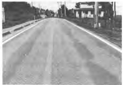
写真-1 アスモルが一部飛散した状況
