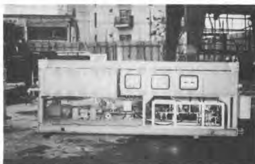
写真-3 気泡注入設備台車
