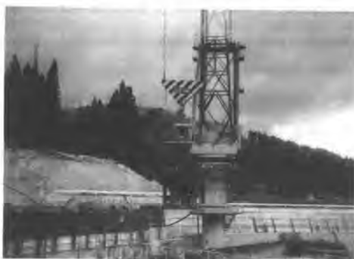
写真-1 自動運転状況
