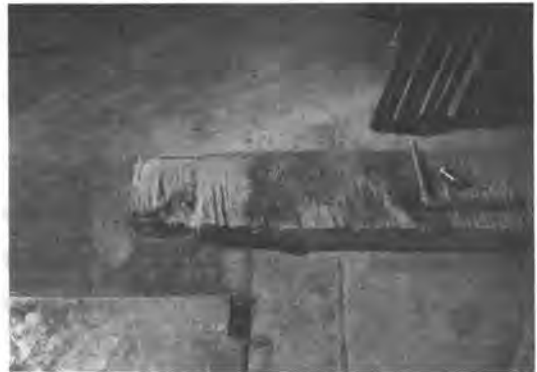
写真6 床面付近の切れ残り部
