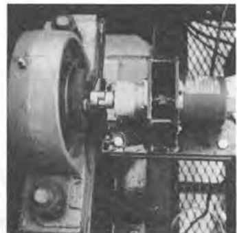
写真3 センサー設置状況
