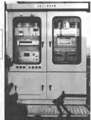
写真-4 自動泥水管理装置
