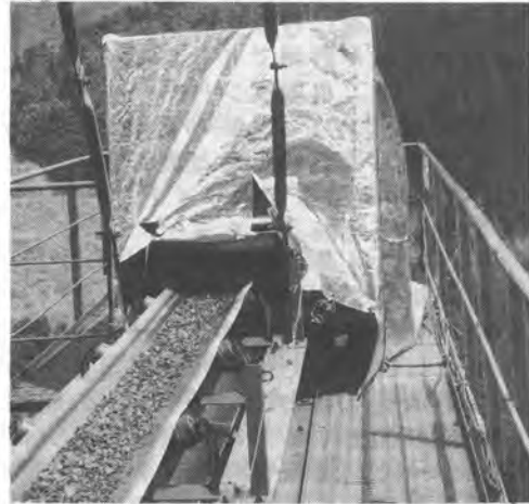
写真-1 カメラ架台
