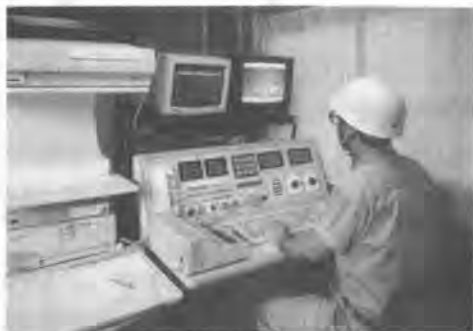
写真-1 運転操作監視の状況
