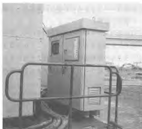
写真-2 集中管理制御装置
