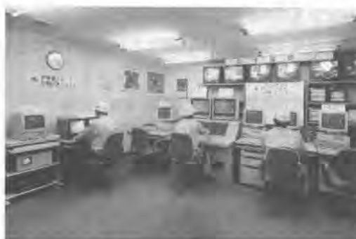
写真-10 中央操作室
