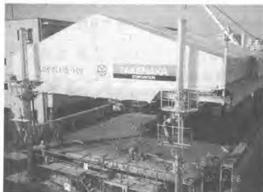
写真-1 全天候屋根装置全景
