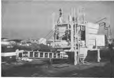
写真1 プラント全景
