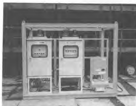
写真-5 制御盤、油圧ユニット
