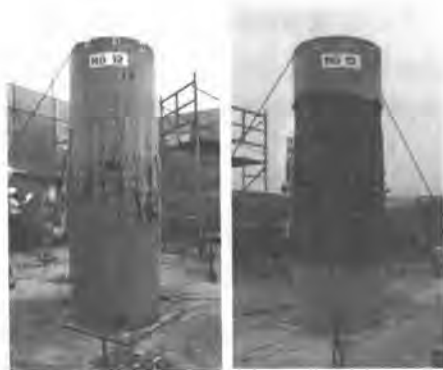
写真-1 制御爆破（かぶりコンクリートによる一次破碎）の剥離状況の例
