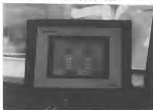
写真-3 制御装置の入力装置 (タッチパネル)
