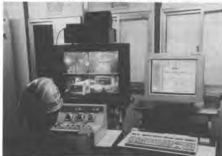
写真-2 中央制御室運転状況
