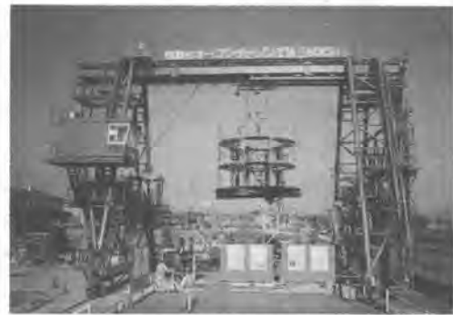
図-3 自動揚土機
