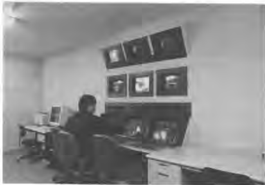
写真－2 中央制御室操作状況
