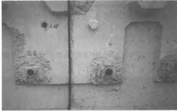
写真-2 側壁コンクリート欠損状況（端部突起部）
