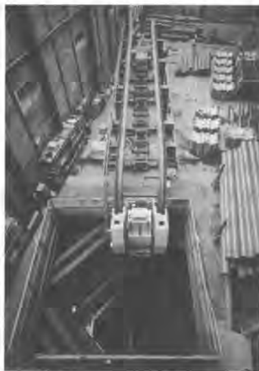
写真-1 搬送システム全景
