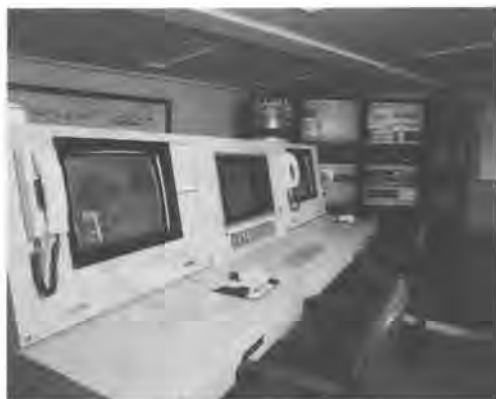
写真-1 中央管理室
