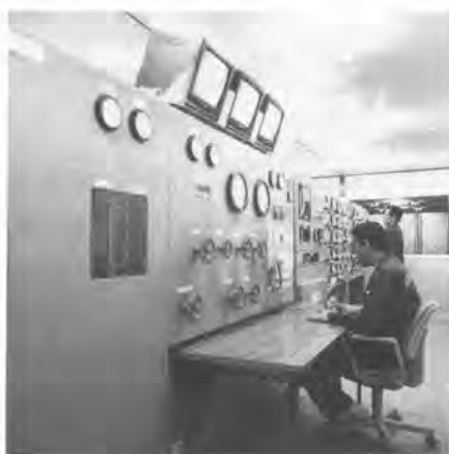
写真-4 混合管理室
