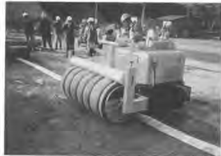
写真-2 残留水吸水装置
