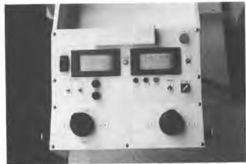
写真-2 コンクリートスプレッダ操作盤
