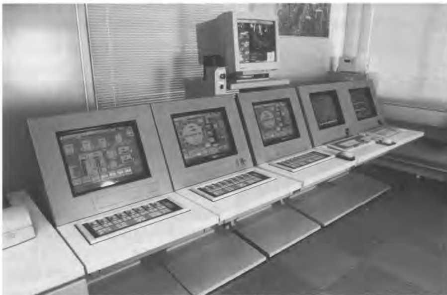
写真-1 統合制御室
