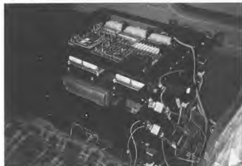
写真-5 制御器ユニット等
