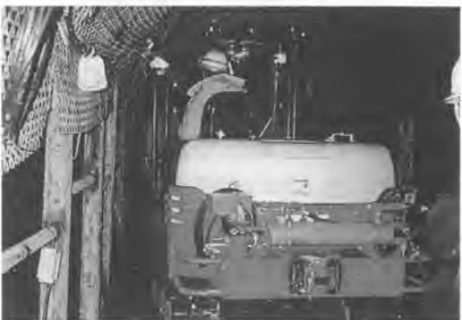
写真-2 油圧装置の外観
