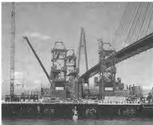
写真-1 地上設備全景
