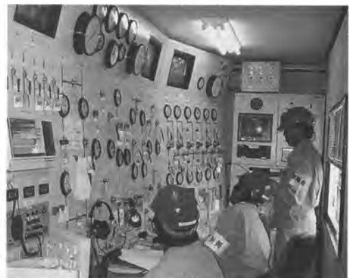
写真-6 管制室操作状況
