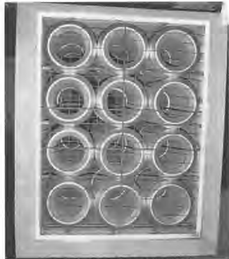
写真-2 主ファンの消音装置
