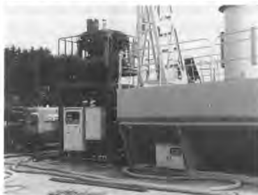
写真-1 PJプラント全貌
