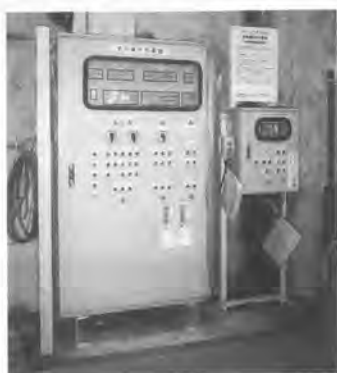
写真-6.坑内制御盤及び操作盤
