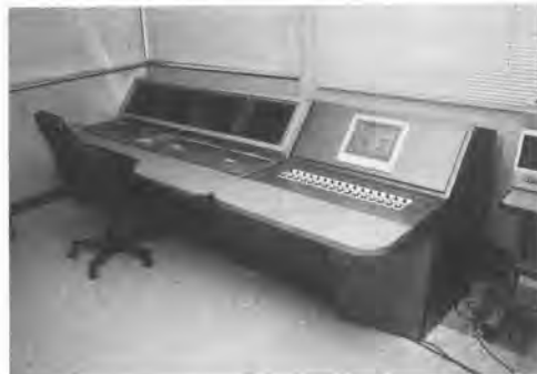
写真-5 集中操作盤
