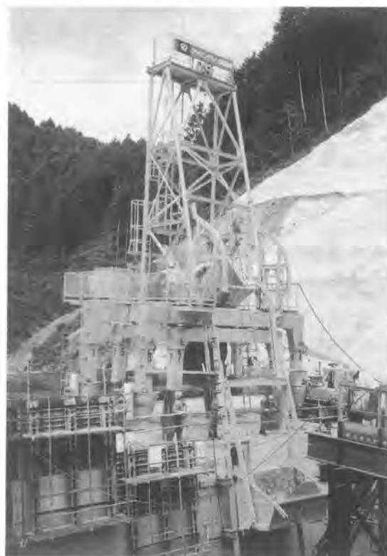
写真-1 設備全景（新設備Ⅰ実証機）
