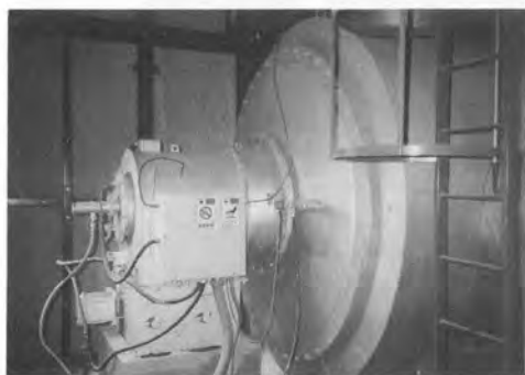
写真-3 バーナー及び脱臭炉
