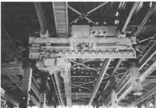
写真3 SCFクレーン(スライド式)
