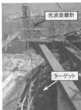
写真-8 揚程計測システム
