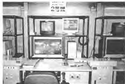
写真-2 遠隔操作システム
