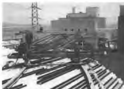
写真3 屋上吊り台車
