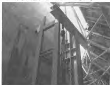
写真-10 振れ止め装置
