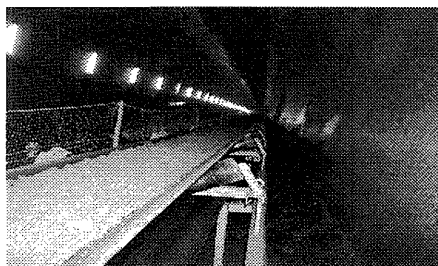
写真-2 延伸ベルトコンベヤ
