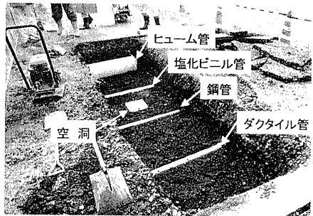
写真-1 疑似空洞・配管埋設状況
