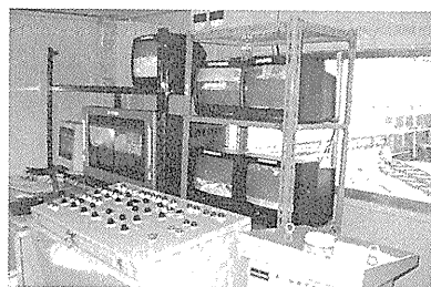
写真-6 遠隔操作室
