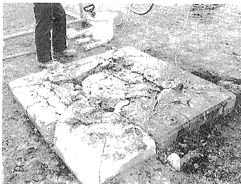
写真－５ 破砕状況
