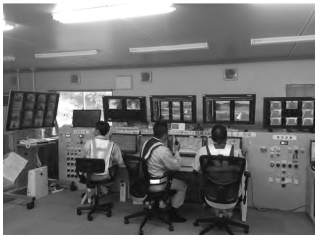
写真-7 中央操作室での制御状況
