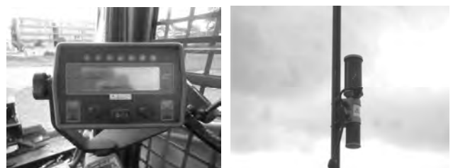
写真-5 制御装置とレーザ受光器
