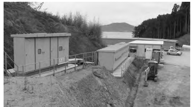
写真-6 破碎機近傍の高圧キュービクル
