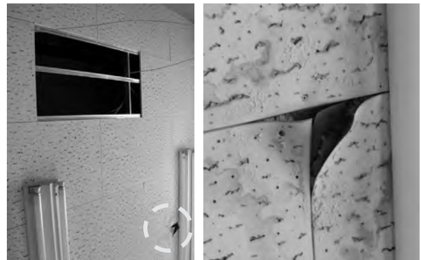
(a) 天井全体 (b) 損傷部詳細
