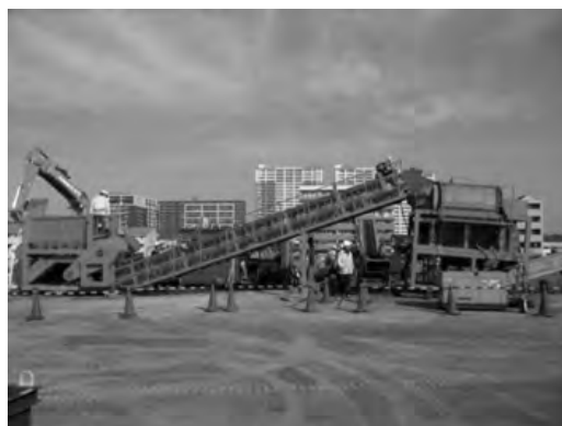
写真-1 乾式分別装置外観
