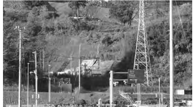
写真-5 特別高圧受変電設備
