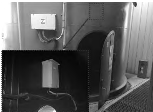
写真-9 危険エリアに設置した磁界発生装置(合材サイロ内)
