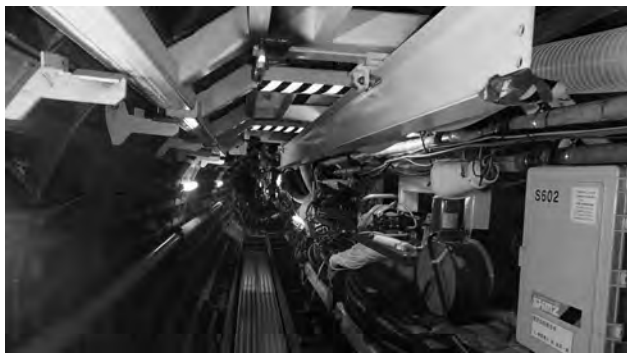
写真-1 セグメントストック装置
