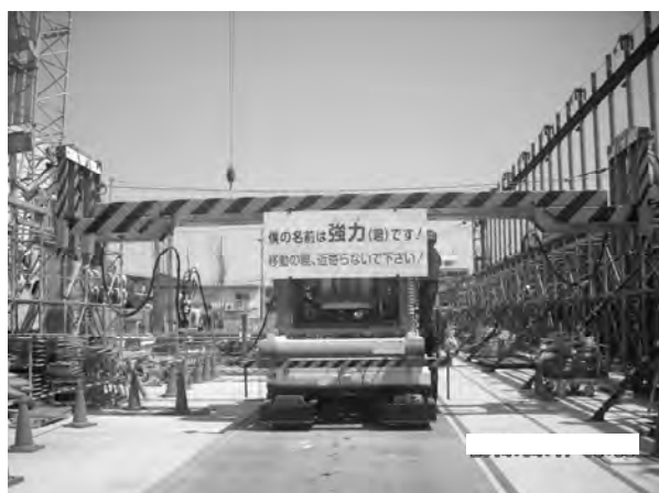
写真-1 装置全景
