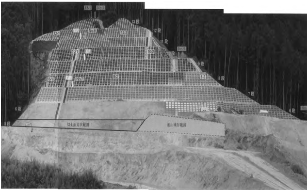
写真-1 法面の動態監視計測機器の状況
