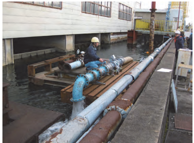
写真-3 工場試験設備による測定状況
