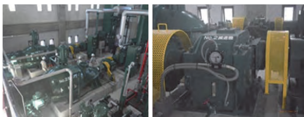
図-1 排水機内部(左)と減速機(右)
