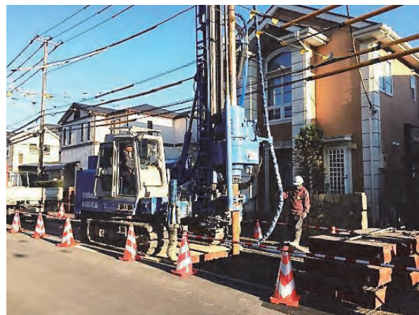
図一2 狭小地対応型 格子状地盤改良工法 ＜スマートコラム工法＞
