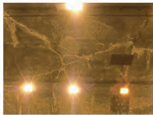
溶脱物の多いスパン
