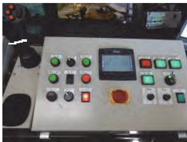
写真-3 遠隔・自動操作盤
