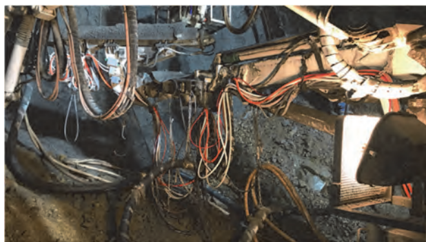
写真-3 配管配線状況
