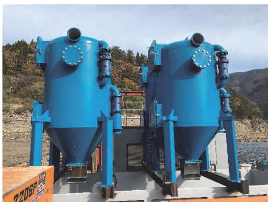
写真-6 大型連続泥土回収タンク
