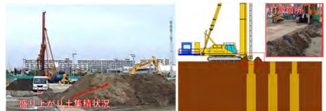
写真-1 盛り上がり土の発生状況例
