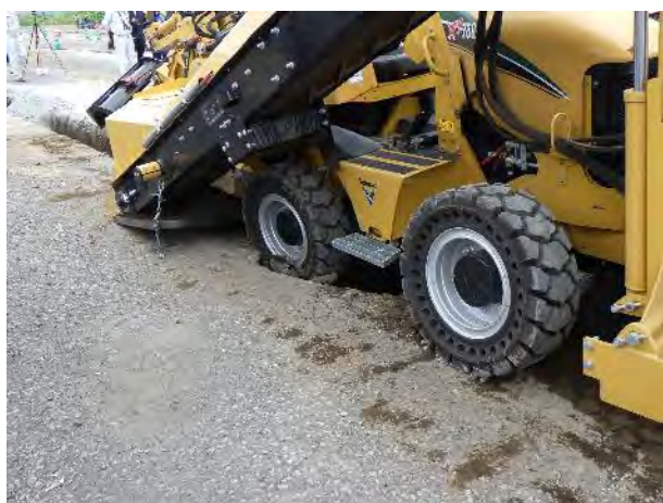
写真-7 掘削肩部での車輪のスタック
