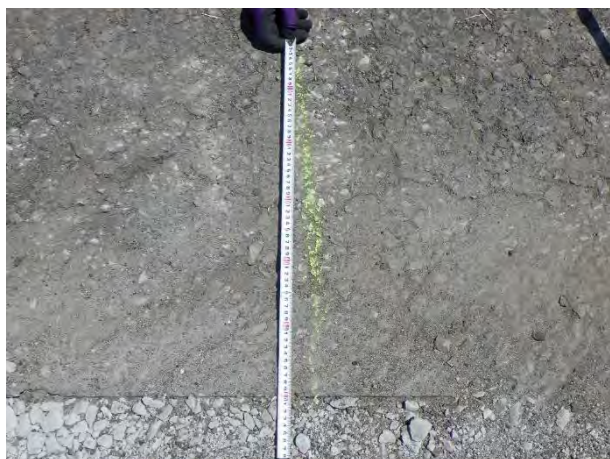
写真-6 舗装上のクラック
