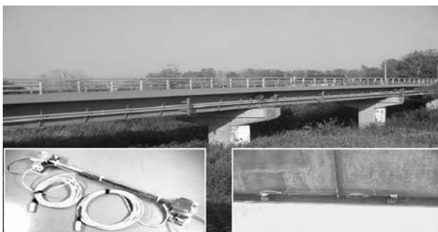
写真一 4 クラック監視中の道路橋
