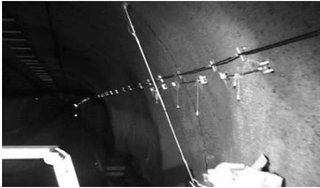
写真一 距離方向センサの設置状況
