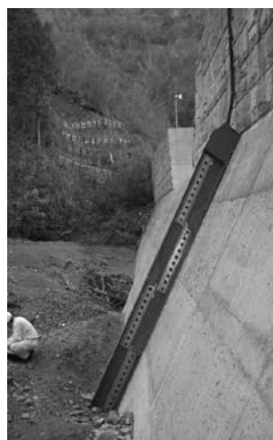
写真—10 堆砂センサ設置状況
