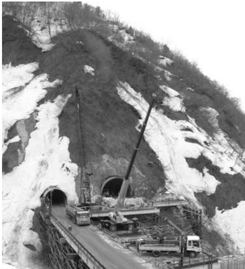
写真一八 坑口部の積雪状況
