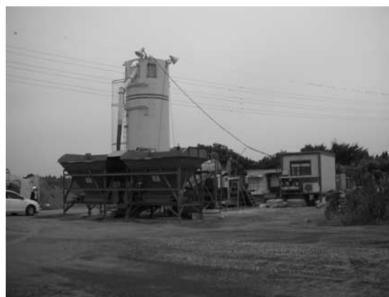
写真—1 定置型フォームドアスファルトプラント(骨材フィーダ側から望む)
