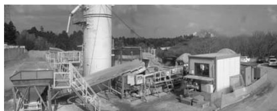
写真—2 定置型フォームドアスファルトプラント(操作室側から望む)
