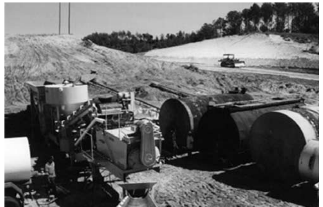
写真—3 SOTER 社製フォームドアスファルトプラント（タイプ PM400）
