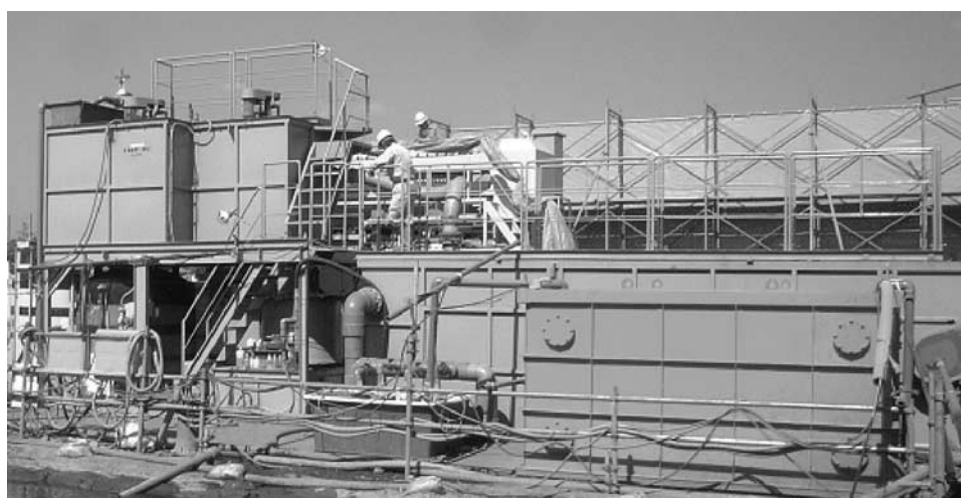
写真—3 除外設備
