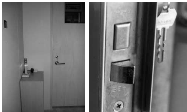
写真—2 入場扉と電気錠
