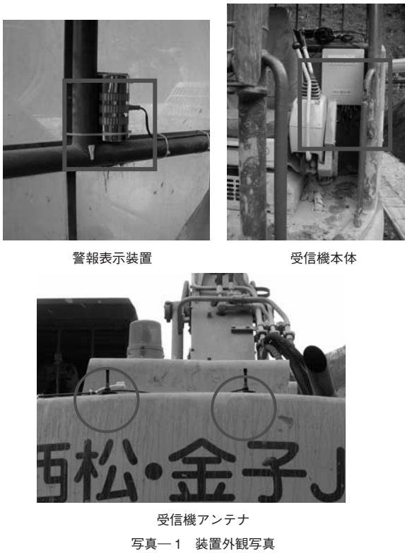
写真－1 装置外観写真
