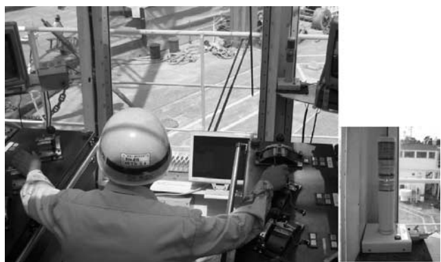
図—7 パトライト設置状況
