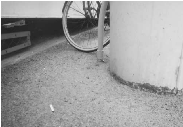
写真一 塗装替後、更なる根腐れが進行中の橋脚
