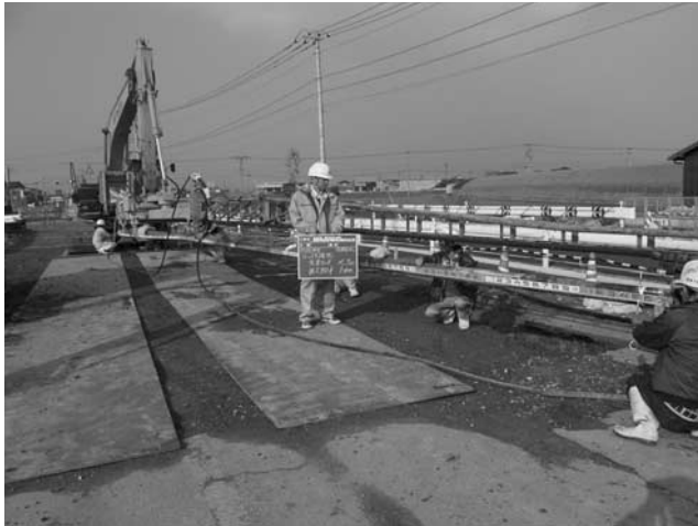
写真—1 リーダー部の倒伏状況
