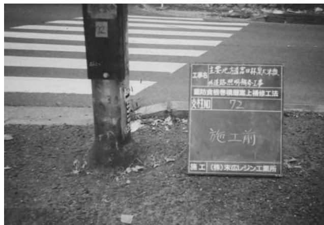
写真—1 根腐れ現状
