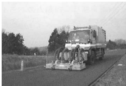
図一七 低騒音舗装の機能維持装置
