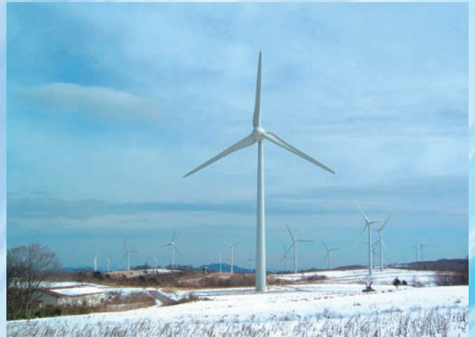
⇧ 2,000 kW 風力発電機
