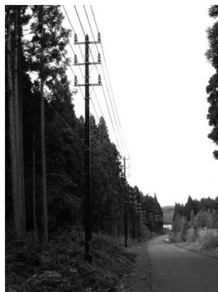
写真—2 コンクリート柱送電線
