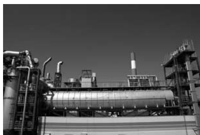
写真—2 熱分解ガス化炉
