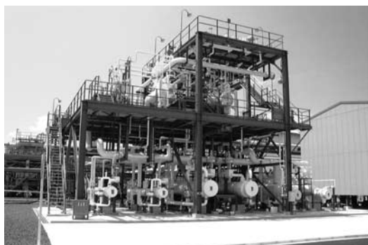
写真-1 BOG処理設備の全景
