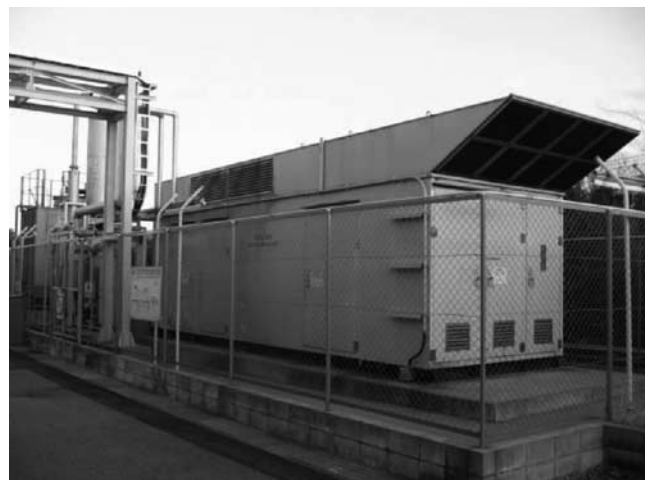
写真—2 バイオガス式ガスエンジンユニット外観（エンクロージャ収納）
