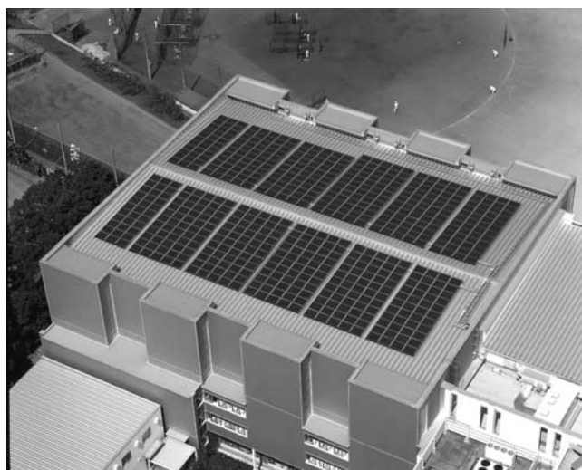
図—2 太陽電池モジュール全景
