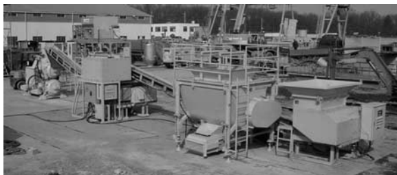
写真一11 省スペース型吹付プラント全景
