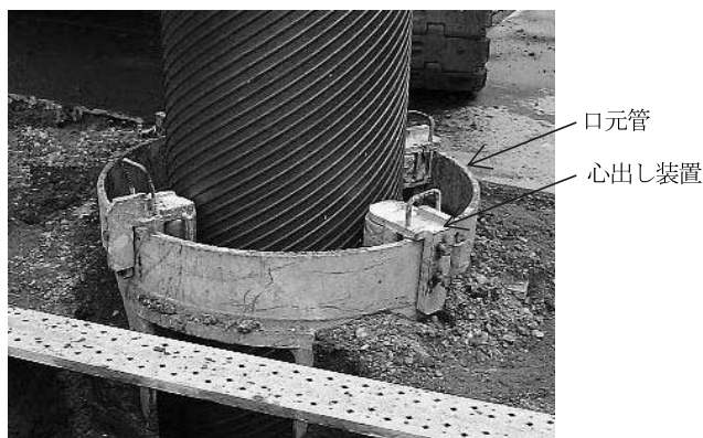
写真—2 心出し装置
