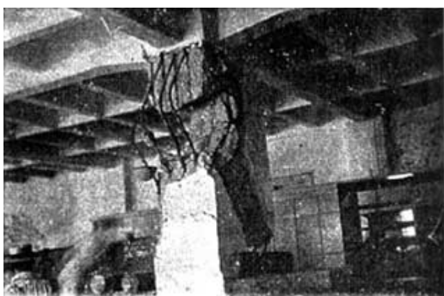
写真第九四 同上 一階附列窓柱ノ被害
