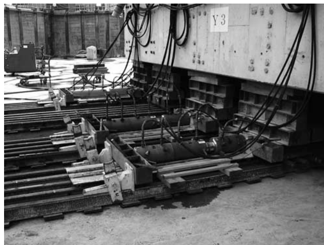
写真-6 推進ジャッキ (3連)
