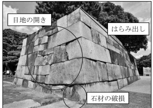
写真—8 中之門石垣修復前状況
