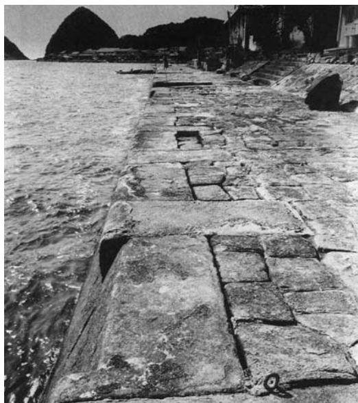
写真—1 修復前の破損した石積埠頭
