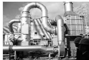
写真—4 脱臭装置
