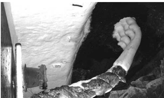
写真-7 接合部二次凍結状況
