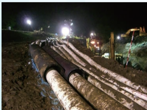
⇧岩手県一関市巖美町市野々原地区 排水は、24 時間体制で運転
