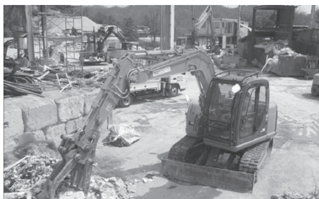
写真—3 稼働状況（産廃処理）
