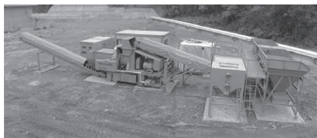
写真一3 フォームドアスファルトプラント
