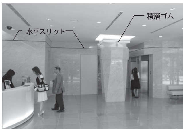
写真一 3 積層ゴムが設置された柱
