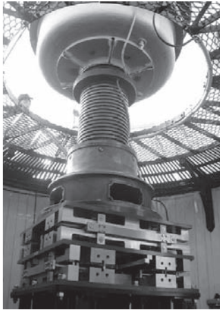
免震装置設置状況（水の子島：3等）
