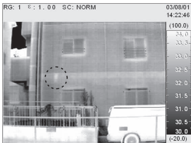
写真—6 赤外線画像（タイル張り）
