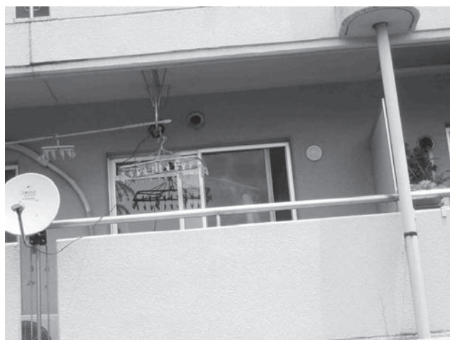
写真—3 可視写真（吹付けタイル）
