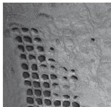
写真—2 トロンメルへの再生材の付着状況 (140℃)
