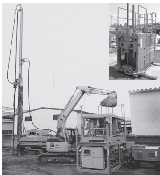
写真2 システム全景
