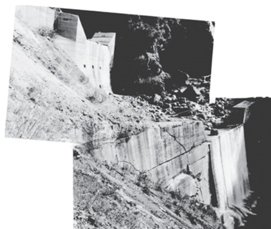
写真—2 柳谷第 3 号砂防えん堤の右岸袖部の亀裂（昭和 54 年）
