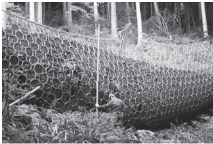
写真—6 リングネット落石防護柵による土砂捕捉事例（奈良県）
