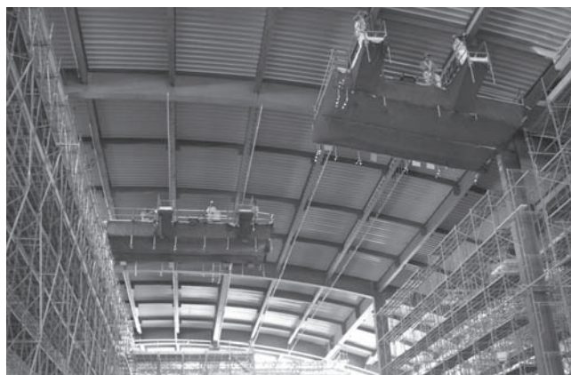
写真—9 新ドーハ国際空港
