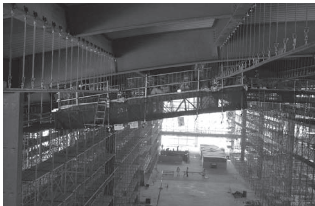
写真—10 新ドーハ国際空港
