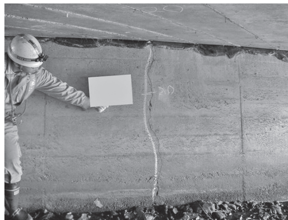
写真—1 乾燥収縮により発生した橋台のひび割れ
