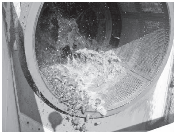
写真—6 スクラバ排出側トロンメル
