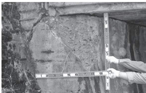
写真—4 凍害を受け、桁かかり部分に剥落が生じた橋台
