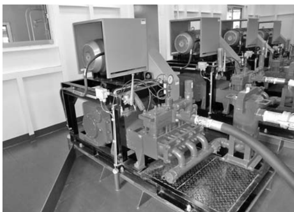
写真-5 グラウトポンプ
