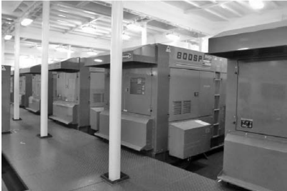
写真－２ 可搬式発電機
