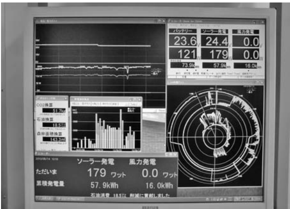
写真— 11 太陽光・風力発電管理画面
