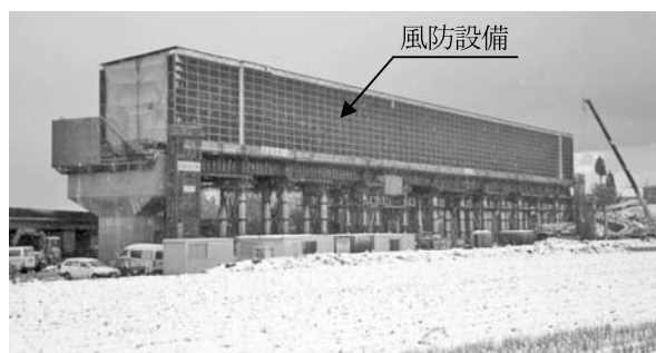
写真-1 風防設備
