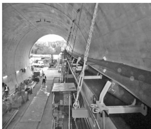
写真一3 連続ベルトコンベヤ
