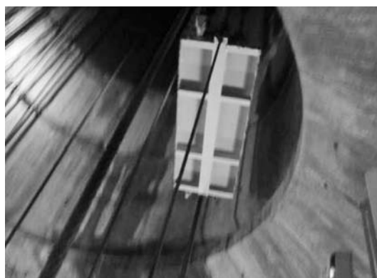
写真-12 エレベーター
