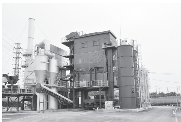
写真—4 アスファルトプラント
