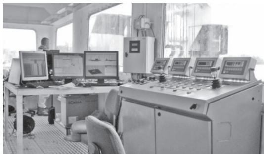
写真—5 昇降・開閉ウインチ操作卓
