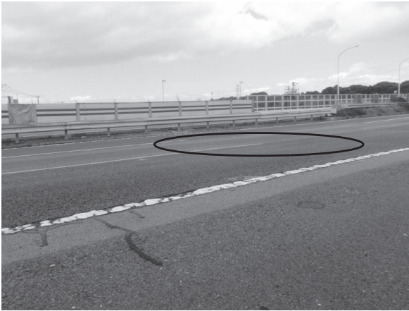
写真—10 路面沈下状況
