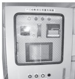
自動減圧装置
