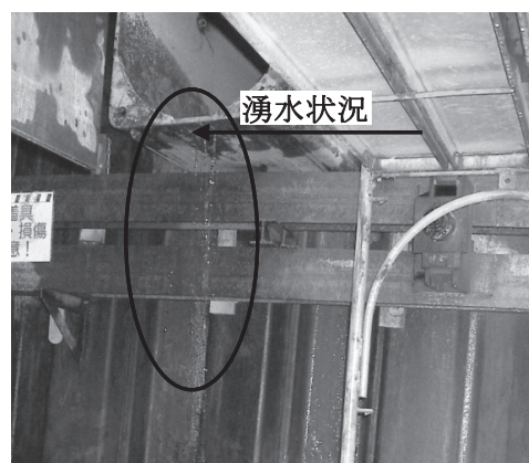
写真—9 湧水状況
