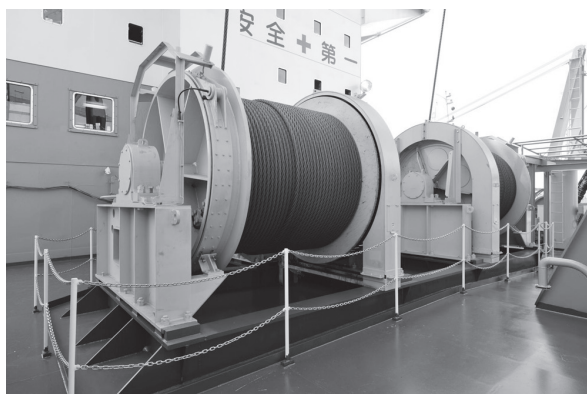
写真-11 昇降ウィンチ
