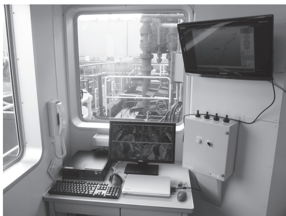
写真-10 遠隔洗浄室
