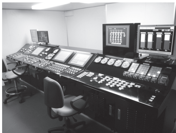
写真—8 機関監視室
