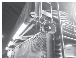
写真—15 坑内スピーカー
