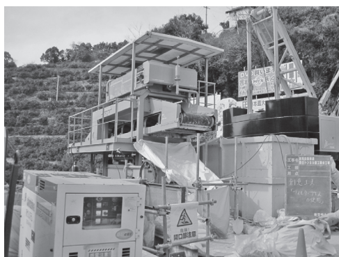
写真11 泥水処理設備
