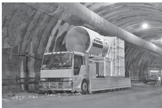
写真-1 稼動中の高効率電気集じん器
