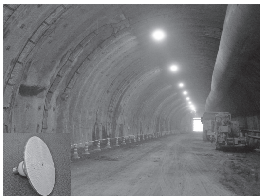
写真-2 坑内LED照明
