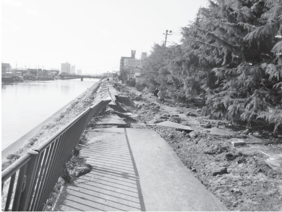
写真― 9 津波の力の凄さ (多賀城砂押川)
