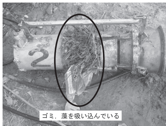
写真—5 引き上げ直後の排水ポンプ
