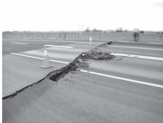
写真一 1 橋梁前後に生じた段差
