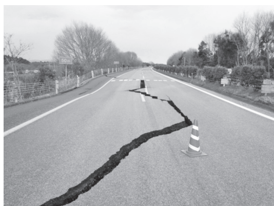
写真一 2 盛土の変状に伴って生じたクラック
