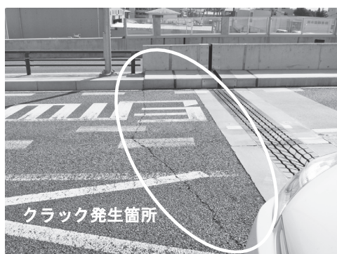
写真—3 ひび割れ発生箇所（A2 橋台）
