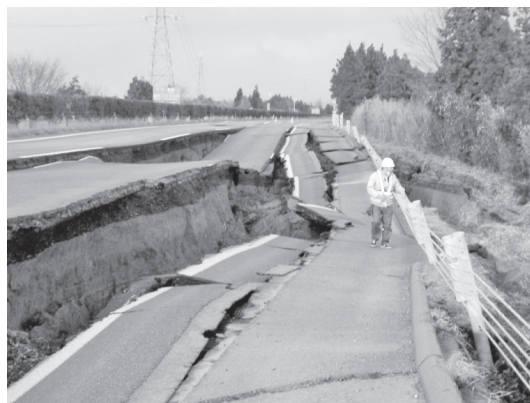
写真一 3 常磐道上り 92.5KP の盛土崩壊
