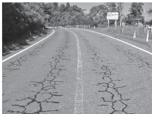
写真—10 路面状況（施工前）
