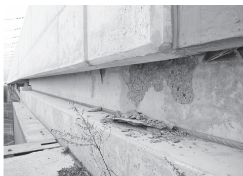
写真—6 鐙川橋底版破損状況
