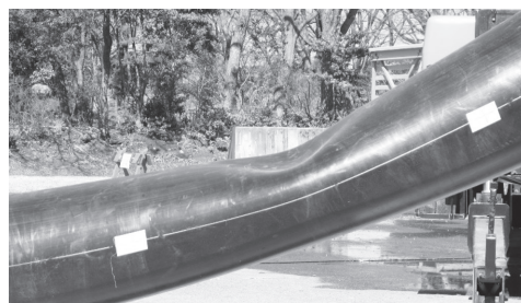
写真－4 高密度ポリエチレン管の変形状況
