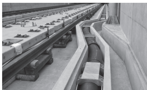
写真—10 送水本管
