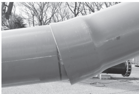
写真—6 硬質塩化ビニル管の変形状況
