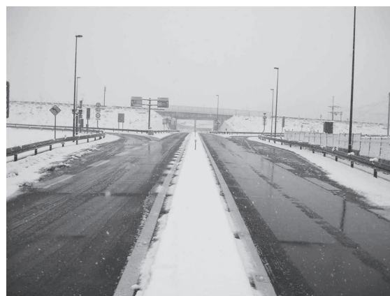
図一13 山東ICにおける無散水融雪パネルの融雪状況
