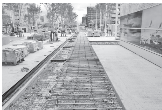
写真—4 地中熱ヒートパイプ方式の配管状況
