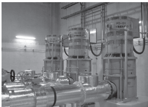
写真—7 送水ポンプ（金浜消雪基地機械室内）
