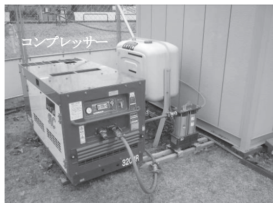
写真-2 空気供給源（コンプレッサー）
