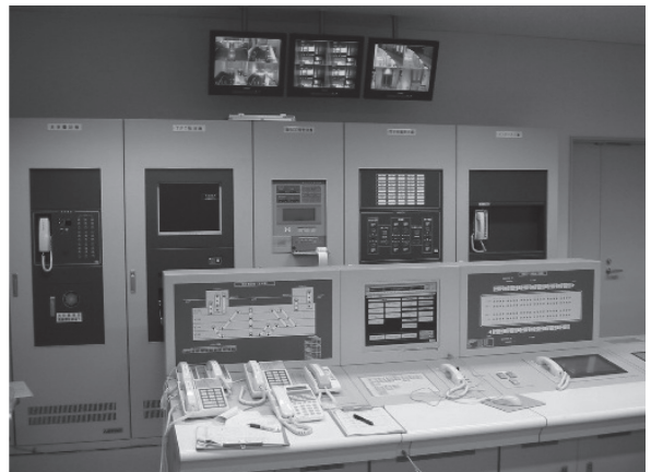
写真—2 防災管理室
