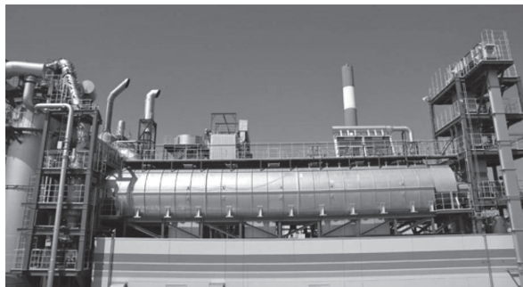
写真-3 熱分解ガス化炉
