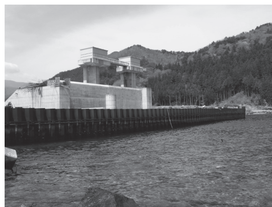
写真—2 被災した水門
