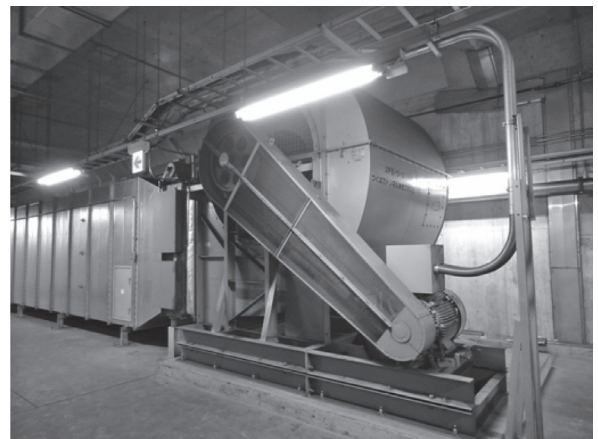
写真—5 トンネル排煙機
