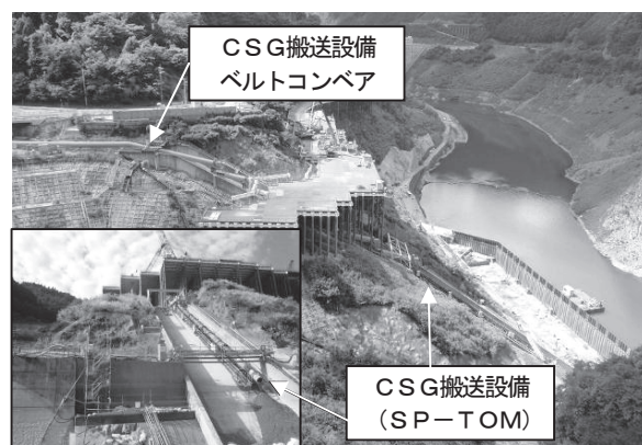
写真—9 CSG 搬送設備
