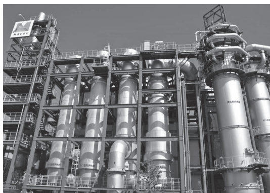
写真-4 空気予熱器と燃焼室（左：炭化物 右：ガス）
