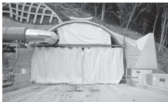
写真— 13 坑口部防音シート
