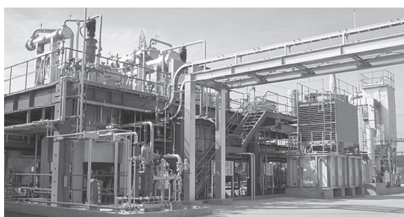
写真—2 バイオディーゼル燃料製造プラント 4)
